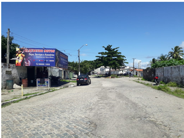
Foto 1 – Rua Cleto Campelo – Trecho Inicial, sentido Cabedelo João Pessoa.
